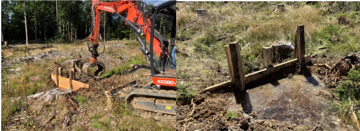
Abbildung 6: Grabensperren in Bereich Weidelbacher Struth
